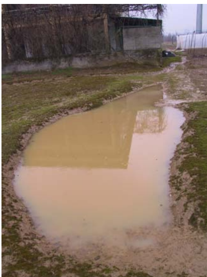
Foto 15: Zona 22, ristagno di acqua dovuto alla composizione limoso-argillosa del terreno.
