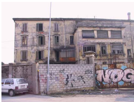
Foto 4: Zona 6, edifici dismessi dal lato di via G. David.
