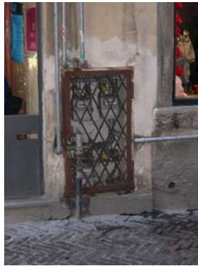
Cono di ripresa n. 9 Impianti tecnologici ad alto impatto ambientale sull'unità edilizia n.7
