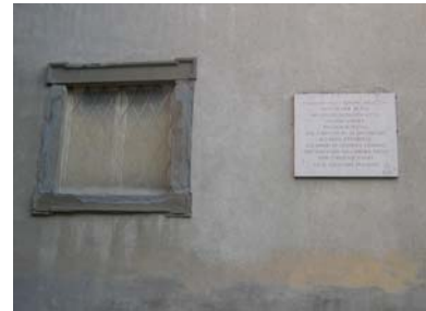
Cono di ripresa n. 7 Finestra trompe l'oeil ed iscrizione sulla facciata di Palazzo Terzi (unità edilizia n.2)
