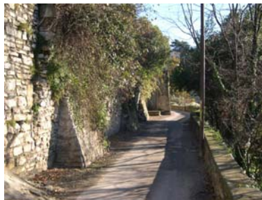
Cono di ripresa n. 4 Paramento murario da valorizzare in via degli Orti
