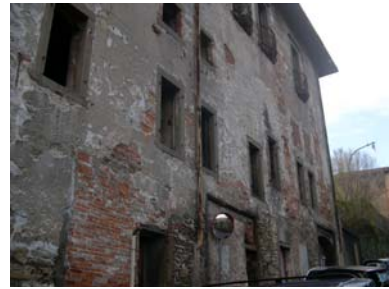
Cono di ripresa n. 10 Intonaco antico, facciata fatiscente dell'unità edilizia n.6
