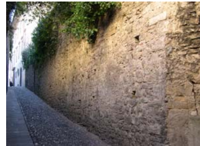
Cono di ripresa n. 7 Paramento murario da valorizzare in via san Salvatore
