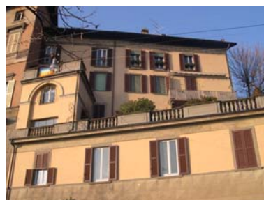
Cono di ripresa n. 12 Decorazione pittorica sottogronda sulle unità edilizie n.1 e n.4
