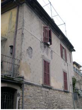
Cono di ripresa n. 4 Graffiti sull'unità edilizia n.5
