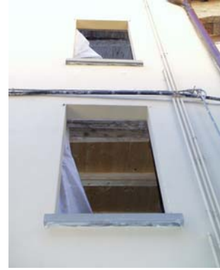
Cono di ripresa n. 2 Intervento recente sulla fascia superiore dell'unità edilizia n.1
