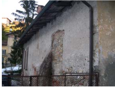
Cono di ripresa n. 9 Ordinamento architettonico dipinto conservato parzialmente sull'unità edilizia n.7
