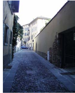
Cono di ripresa n. 1 Paramento murario da valorizzare in via San Pancrazio
