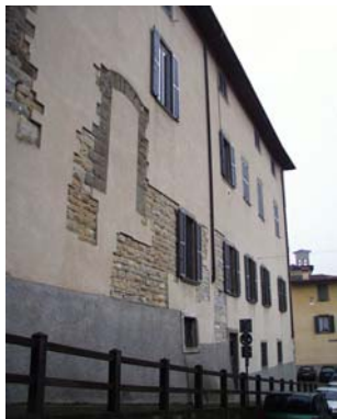
Cono di ripresa n. 11 Elementi strutturali antichi a vista sulla facciata dell'unità edilizia n.4
