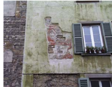
Cono di ripresa n. 13 Tracce di decorazione pittorica sulla facciata dell'unità edilizia n.5
