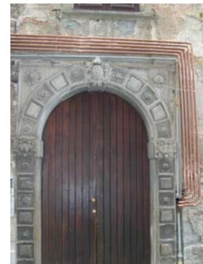
Cono di ripresa n. 14 Canalizzazioni tecnologiche esistenti dall'alto impatto ambientale sull'unità edilizia n.3 da rimuovere e ricollocare
