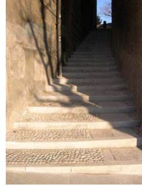
Cono di ripresa n. 7 Gradinata in via Rosate
