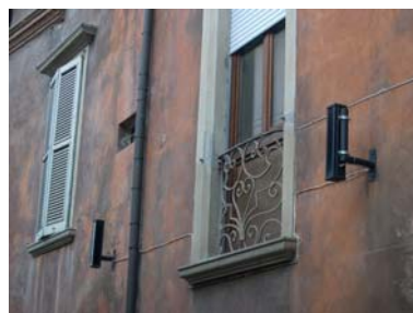
Cono di ripresa n. 7 Particolare del parapetto in ferro dell'unità edilizia n.1
