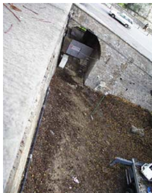
Cono di ripresa n. 2 Elementi tecnologici al di sotto del viale di accesso alla Porta Sant'Agostino
