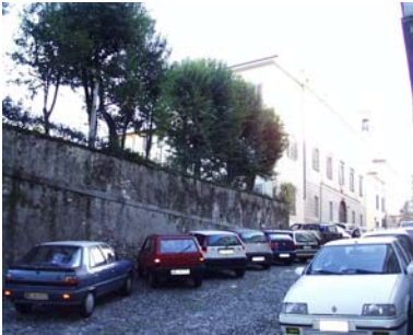
Cono di ripresa n. 1 Paramento murario da valorizzare in via San Salvatore
