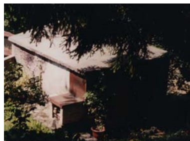
Cono di ripresa n. 14 Unità edilizia n.9: Realizzazione di copertura in coppi e intonacatura delle pareti perimetrali. Soluzione da integrare alla sistemazione dello spazio aperto privato ed all'intervento sull'edificio principale
