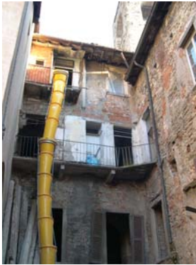
Cono di ripresa n. 3 Facciata fatiscente dell'unità edilizia n.3 e cantiere
