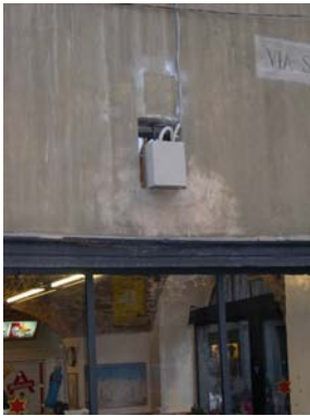
Cono di ripresa n. 8 Particolare di impianto tecnologico sull'unità edilizia n.10
