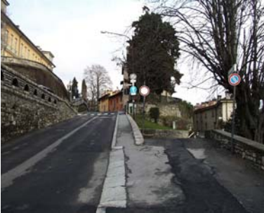
Cono di ripresa n. 1 Paramento murario da valorizzare in via Pallavicino Sforza
