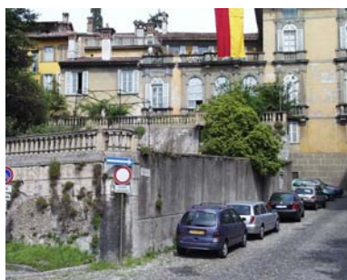
Cono di ripresa n. 8 Paramento murario da valorizzare in via Osmano e viale delle Mura
