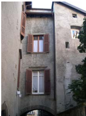
Cono di ripresa n. 7 Particolare del passaggio sotto costruzione in vicolo Mercato del Fieno
